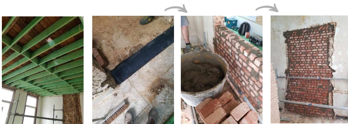
Photos prises sur chantier le 27 juin 2023. On peut y voir : L'installation des gites de renfort du plancher et le chainage, ainsi que le maçonnerie de l'ouverture près de l'entrée de la maison (étanchéité, mortier et ouverture rebouchée)
