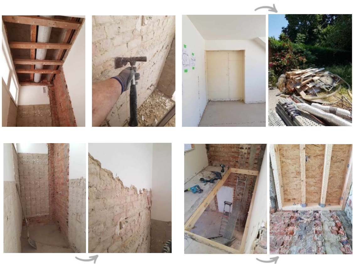
Photos prises sur chantier le 14 juin 2023. On peut y voir : Le faux plafond démoli, un marteau hache, le mobilier encastré démoli, la démolition de l'enduit et la trémie de l'ancien escalier rebouchée à l'aide de gites et d'OSB.
